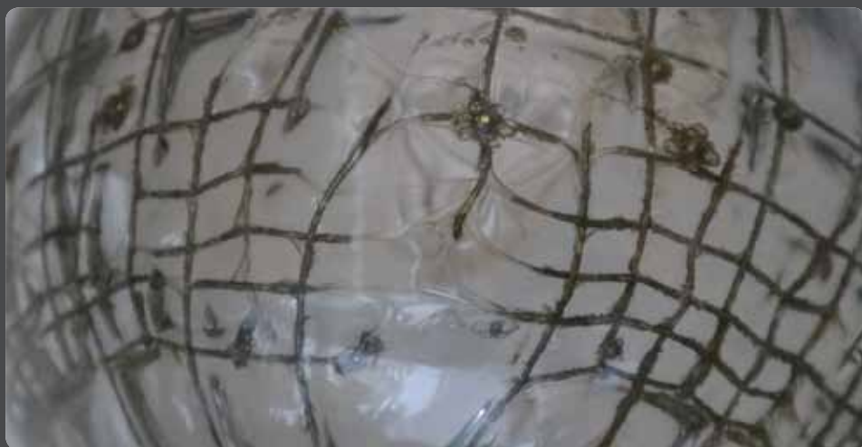
Abb. 06 Detail des zerstörten Messinggitters
